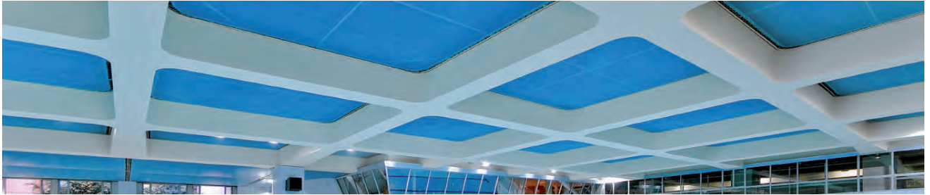
Lunaperf 30° - réalisation : Filmatec - M.Elbaz
