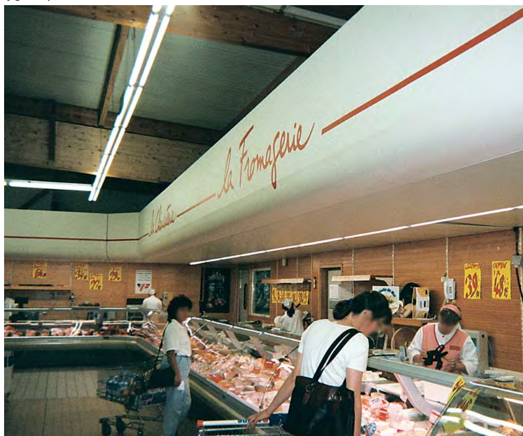
Les dalles sont en Barrisol pour une hygiène parfaite.
